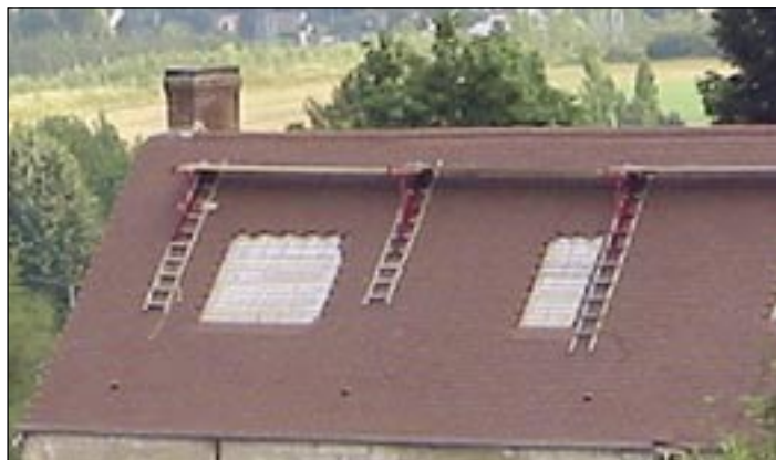
Tuiles plates uniformes et Velux™ trop nombreux détruisent l'harmonie de ce toit
