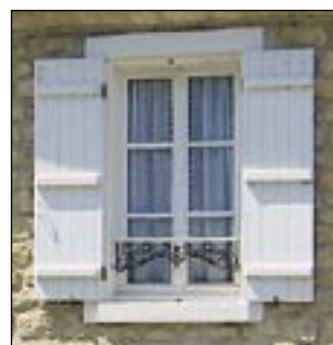
Volets pleins à 3 barres. L'encadrement blanc de la fenêtre et les joints en ciment gris sont à proscrire
