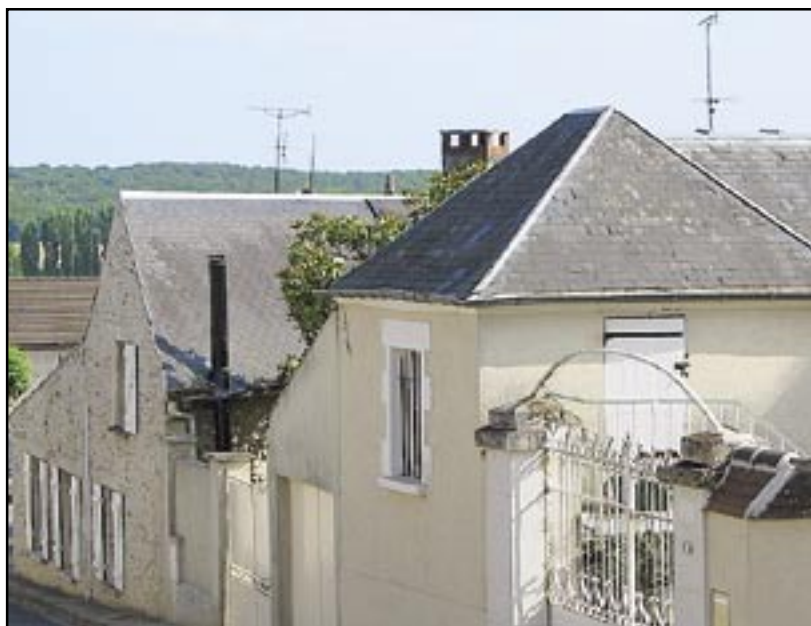
Maison de bourg couverte en ardoise. Faîtage et arêtes sont recouverts de zinc. Une gouttière nantaise reposant sur la corniche eut été préférable à une gouttière pendante.
