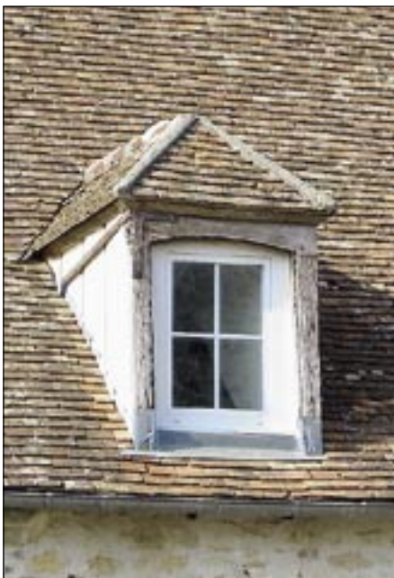
Lucame en retrait sur la toiture à trois versants de toiture. On la dit « à capu- cine » ou « à bout rabattu »
