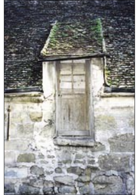
Modeste lucame porte rampante à ouver- ture étroite. La pente suit celle de la toiture. Elle est maintenant pastichée par les larges « chien-assis » sans légitimité vexinoise
