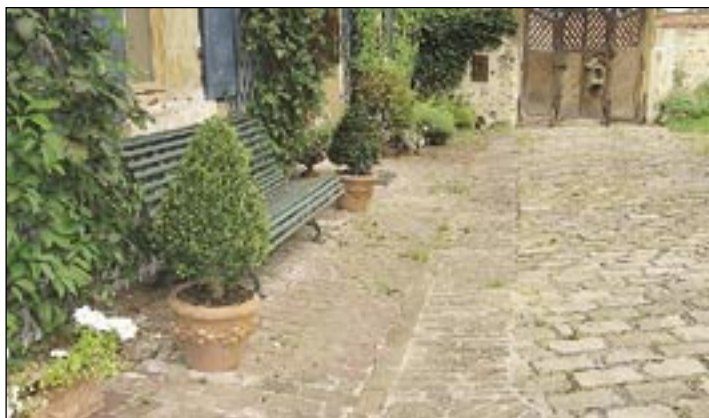
Sol en pente au pied du mur gouttereau sans parterre de fleurs au niveau des murs.
