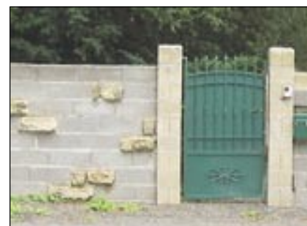
NON à ce mur « nougat » en parpaings rehaussés par quelques pierres et aux piliers sans chapiteaux. La porte métallique est de bonne proportion et de bonne facture.
