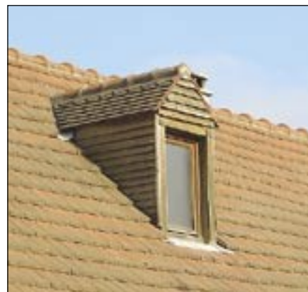
NON au doublage par des tuiles en bois des joues* et du fronton d'une lucarne à bâtière par ailleurs bien implantée et de bonnes proportions
